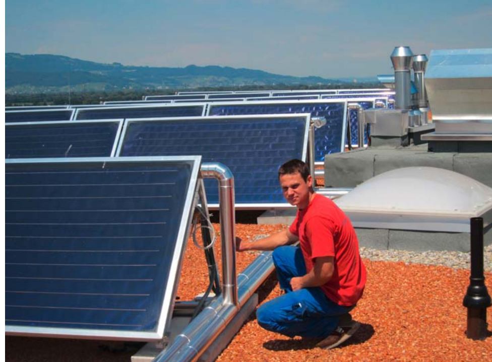
Eine Photovoltaik-Dachanlage der Dorfinstallateure
