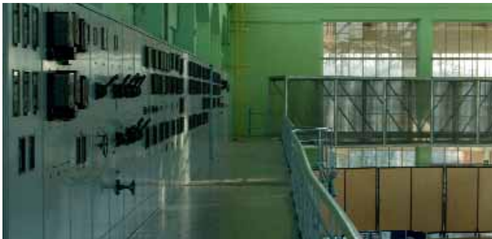
↑ Abgeschaltet: Technik einer Blütezeit auf der Empore der Kraftwerkhalle in Heusden-Zolder.
